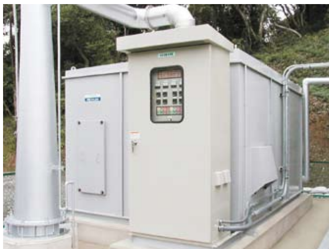
触媒式脱臭装置
